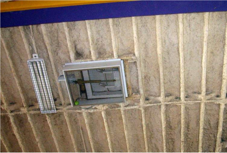
M1: Old Gym Exhaust Fan
